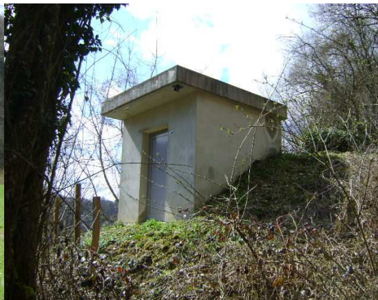
Réservoir d'Ocourt Altitude : 470 m Capacité : 145 m 3 Réserve incendie : 100 m 3
