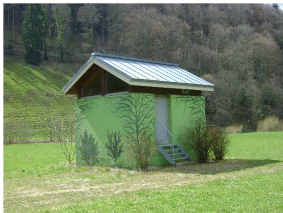
Station de pompage d'Ocourt Capacité de pompage : 2 x 230 ltr/min.
